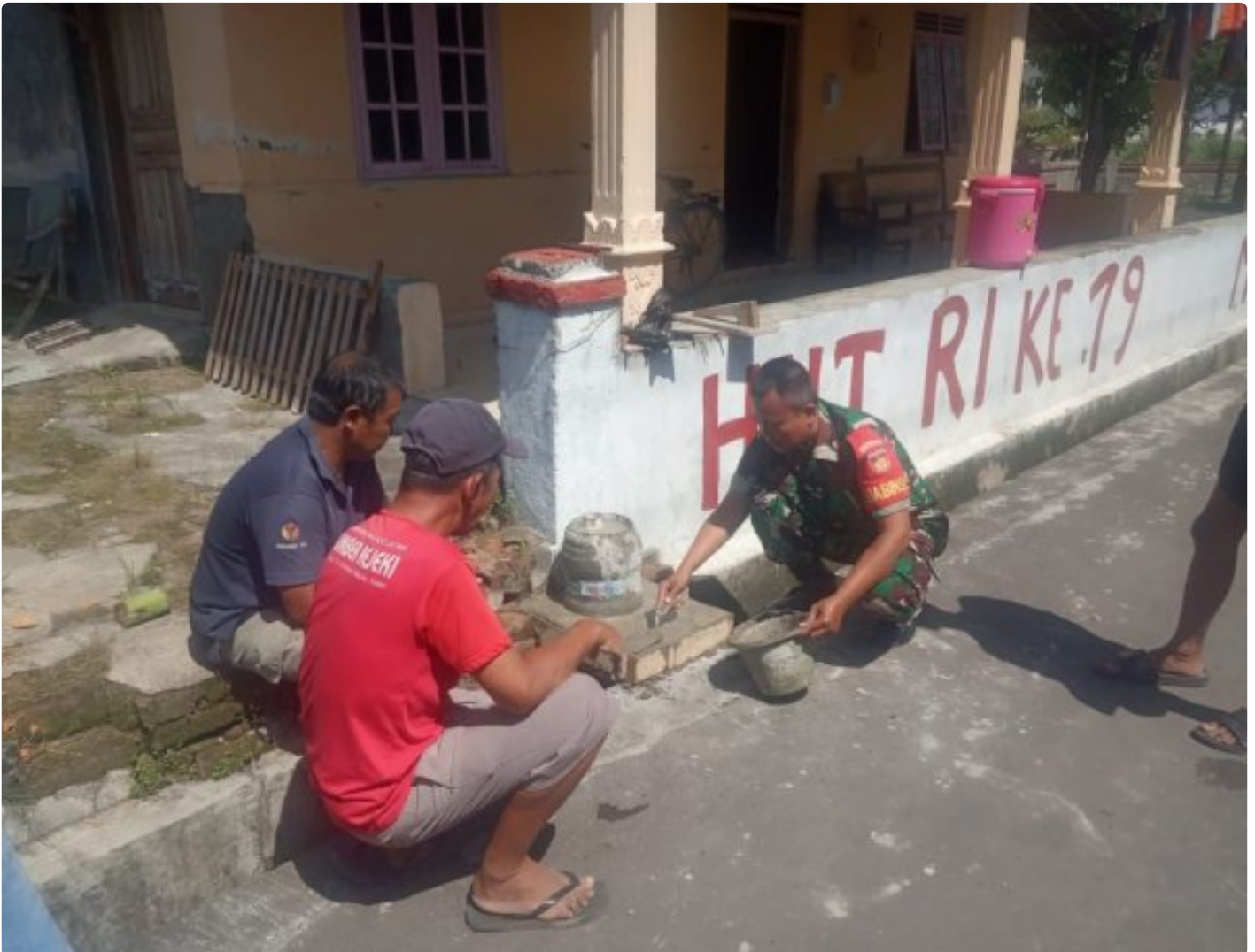
Babinsa Desa Ketandan Klaten Bersama Warga Karya Bakti Pemasangan Tiang Lampu Penerangan Jalan
